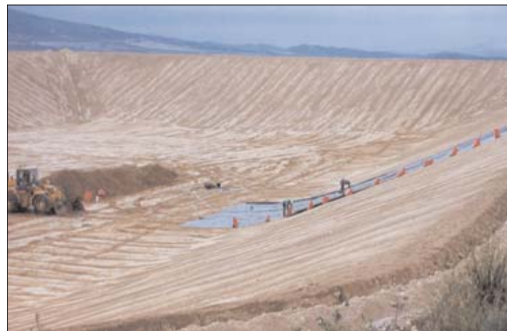
Balsa de riego de enormes proporciones para almacenar agua destinada a nuevos regadíos. Lorca, Murcia.
